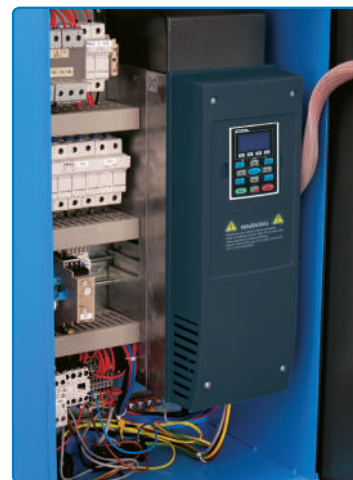
Quadro elettrico e inverter.
