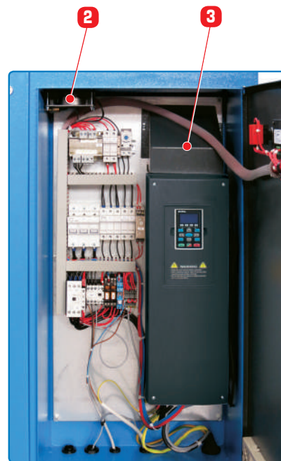
Quadro elettrico e inverter.
