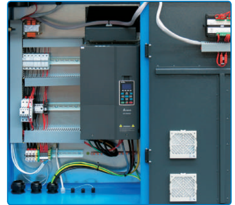
Quadro elettrico e inverter.
